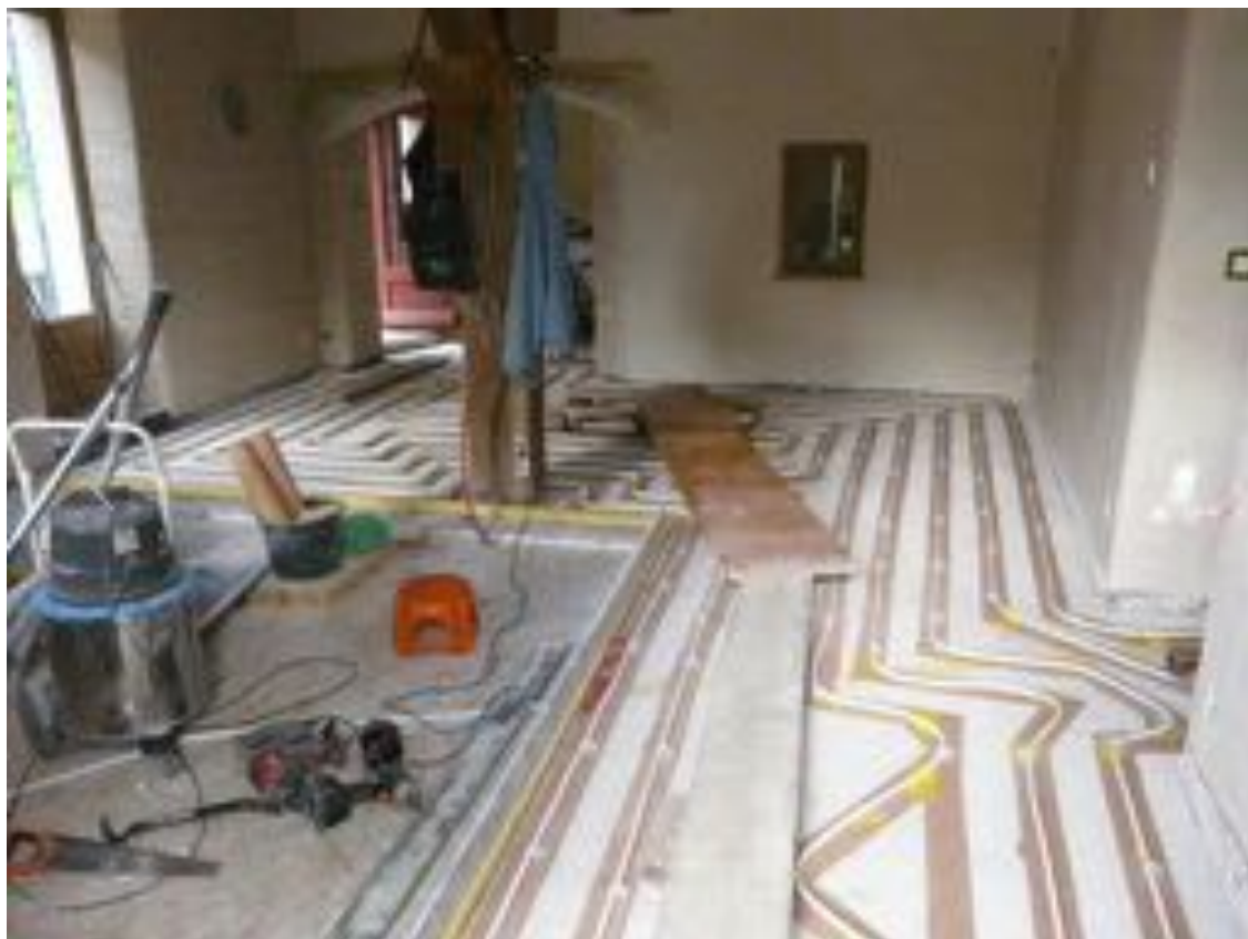
Les tuyaux en multicouche conducteurs de l'eau du chauffage
