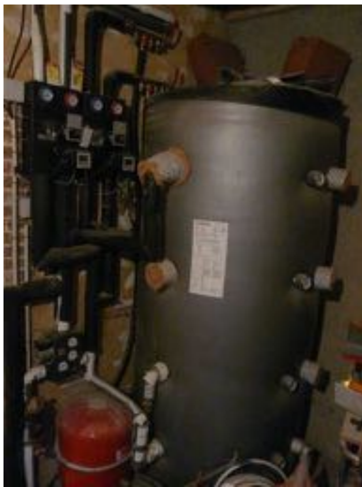
Le ballon tampon de 1000 litres
